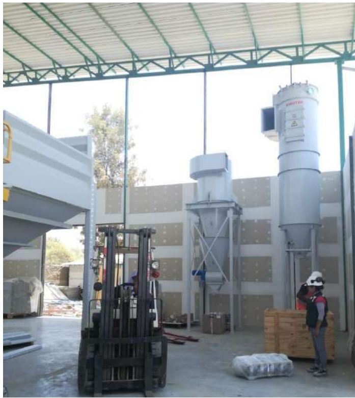
Ilustración 43. Zona de limpieza de Norandino.
