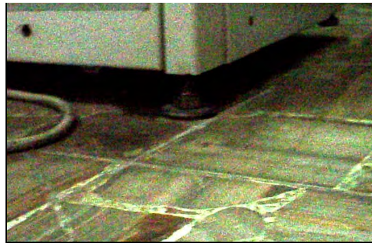
Fotografía 8.7: Detalle de perno de anclaje de Mamógrafo de \varnothing 3/4" . Éste equipo en total posee 4 pernos.
