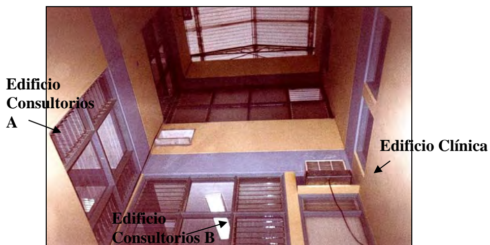
Figura 6.5: Edificios adyacentes que no guardan una separación de junta sísmica como lo establece la norma de diseño sismorresistente. Sus pisos no se encuentran alineados.
