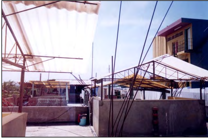
Fotografía 7.1: Clínica San Miguel: Acero de refuerzo expuesto que se encuentra en proceso de corrosión en la azotea de Consultorios A.
