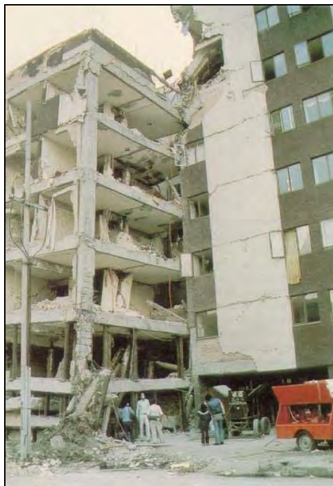
Fotografía 2.2: Daños producidos en un edificio de concreto armado en las columnas, muros de relleno (tabiques), vigas durante el sismo de México en 1985. Fuente: UNAM.
