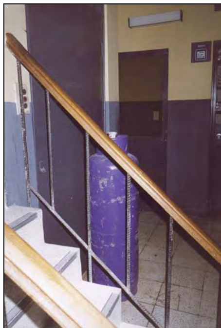
Fotografía 2.4: Clínica San Miguel. Vista de un tanque de gas cerca de la cocina, en caso de un sismo puede volcarse y ocasionar una fuga.
