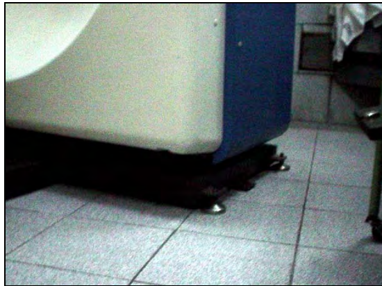
Fotografía 8.6: Detalle de pernos de anclaje del tomógrafo axial. Este equipo posee 4 patas circulares donde se ubica un perno en cada una.
