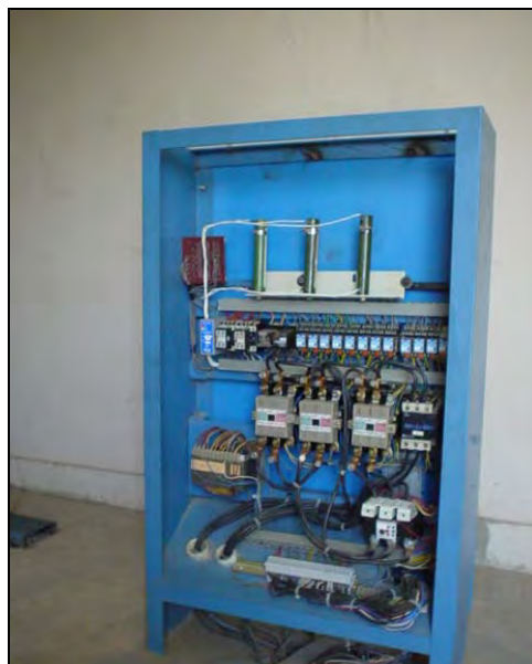
Fotografía 8.4: Vista de tablero de control en la casa de máquinas del ascensor Thyssenkrupp de Clínica. Sus patas se encuentran empotradas a la losa del piso.
