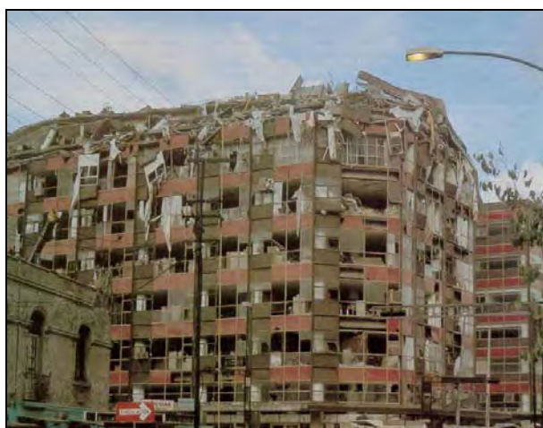
Fotografía 2.1 Daños producidos principalmente en los elementos no estructurales en este edificio durante el sismo de México de 1985. Fuente: UNAM.
