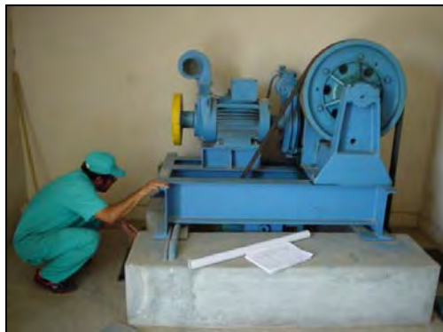
Fotografía 8.3: Motor y polea en casa de máquinas del ascensor Thyssenkrupp de Clínica. Tanto el motor como la polea se encuentran empernados a una viga metálica y esta apoyada 2 bases de concreto armado. Compare el tamaño de este equipo con el de la persona allí presente.
