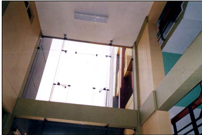
Figura 7.11 Clínica San Miguel. Zona Clínica. Vista de elementos no estructurales (Vidrios) que podrían fallar en caso de sismo. El espesor del vidrio es de 6 mm.
