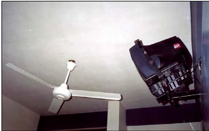
Fotografía 2.5: Clínica San Miguel. Vista de elementos que podrían desprenderse en caso de un sismo fuerte.
