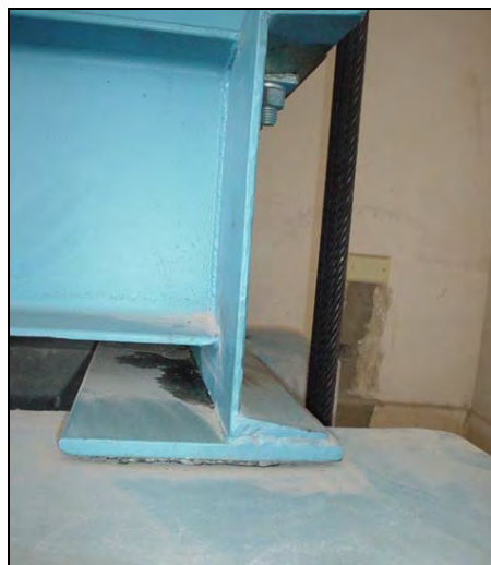
Fotografía 8.8: Casa de máquinas de ascensor Thyssenkrupp. Se observa la viga sobre la cual se apoyan la polea y el motor del ascensor. Estos dos últimos están empernados a la viga.
