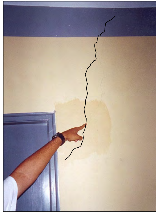
Fotografía 7.4: Clínica San Miguel. Fisura en muro de Consultorios A (Consultorio Dr. Tejero), cerca de Columna 9
