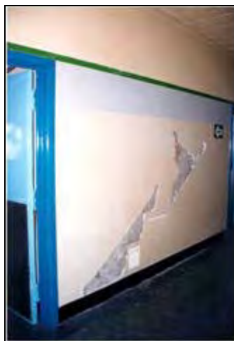
Fotografía 8.1: Daño en tabiquería Hospital Nacional "Carlos Alberto Seguin" de Arequipa tras el sismo de Arequipa del 23 Junio 2000. La Oficina del Departamento del Interior de los Estados Unidos USGS, asignó al evento una magnitud M_w = 8.4 . El Instituto Geofísico del Perú (IGP), reportó la magnitud como M_s = 7.9 .
