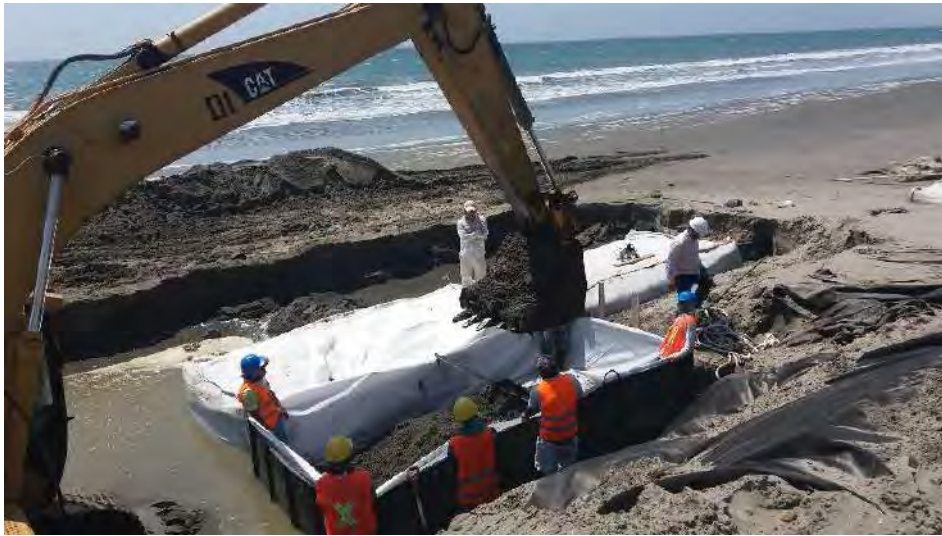
Fotografía C5. Llenado de geobolsas con excavadora. La cuadrilla de 5 peones sujeta la geobolsa durante el proceso
