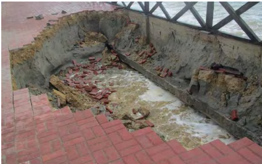
Fotografía D6. Vista interna de la plataforma en la zona donde se produjo la pérdida de la geobolsa.
