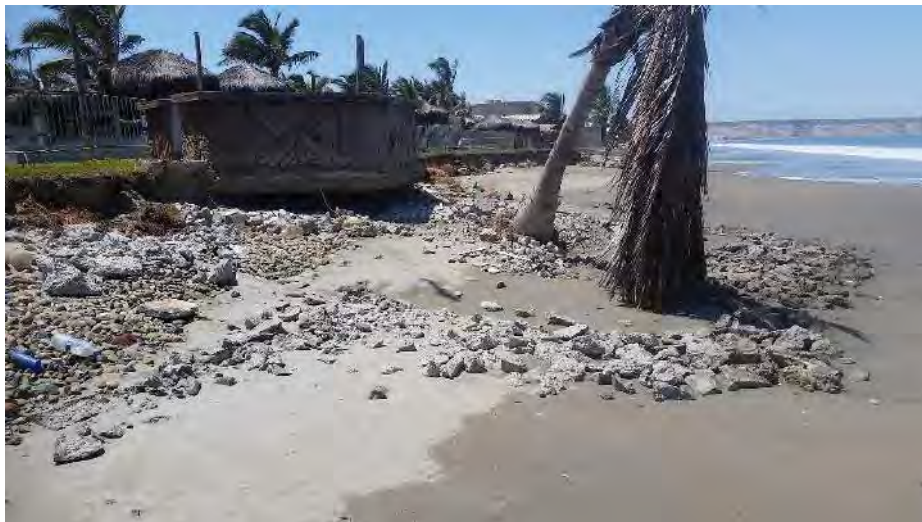
Figura 4. 6. Local comercial Costa Bonita, después de la erosión.
