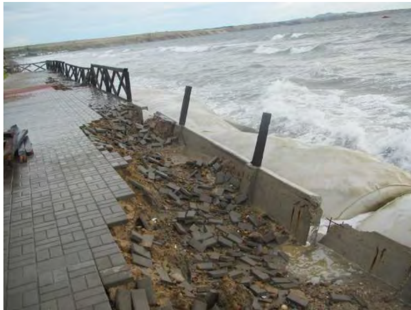
Fotografía D3. Colpaso del muro de contención
