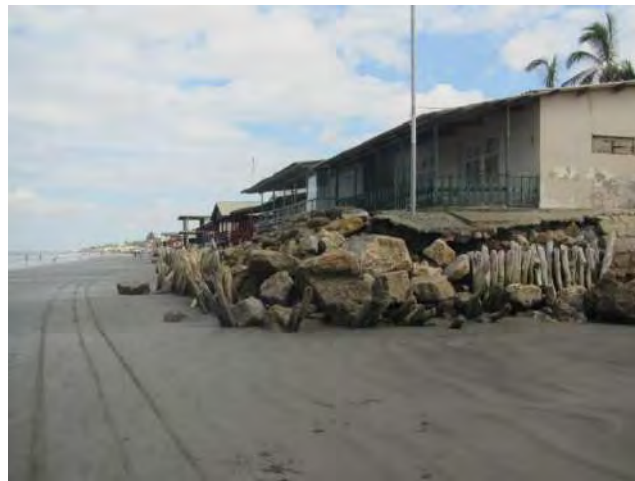
Figura 1. 15a. Solución con enrocado de piedra deficiente, Colán, Piura-Perú
