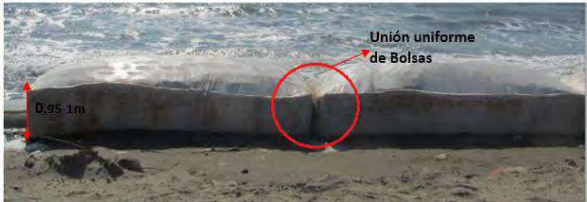
Figura 6. 20. Geobolsas expuestas al oleaje. Altura y unión entre bolsas
