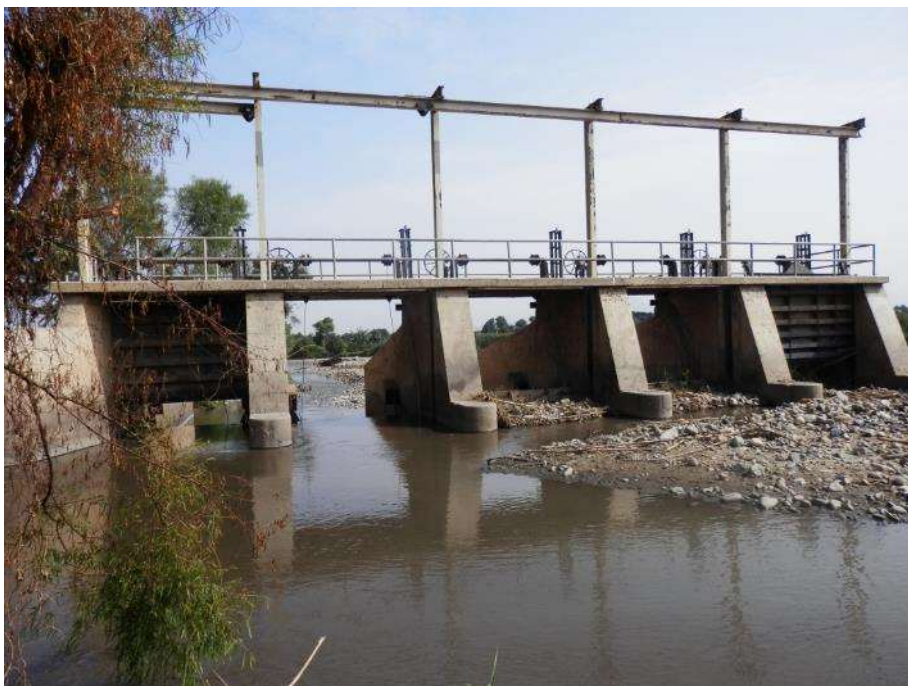
B3. Estado de la Bocatoma Santa Lucía De Moche Fuente: Elaboración propia
