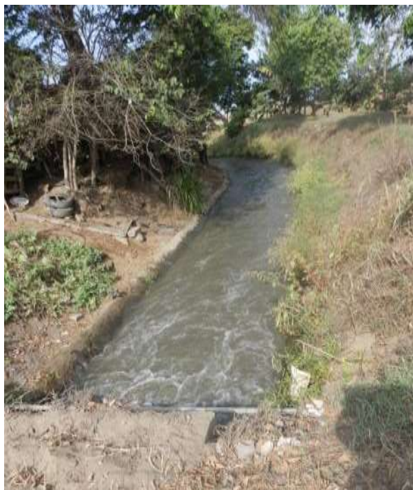
B11. Canal de derivación de segundo orden Fuente: Elaboración propia
