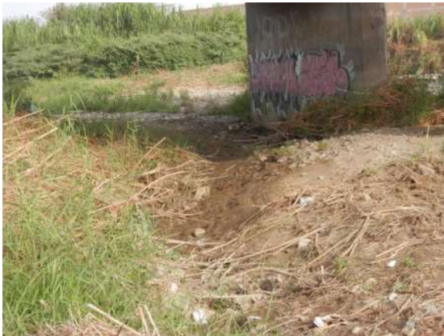
B35. Estado del cauce del río Moche- Altura del Puente Moche Fuente: Elaboración propia
