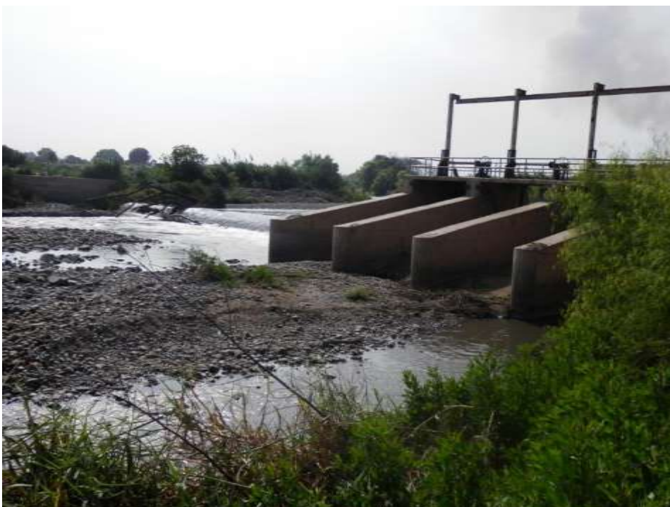
B4. Estado de la bocatoma Santa Lucía De Moche Fuente: Elaboración propia
