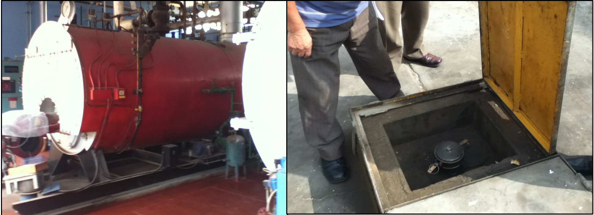
Figura 5.5. Caldero y cisterna de combustible en la casa de fuerza. Instituto Nacional de Salud del Niño.
