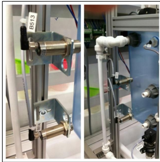
Figura 15 - Sensores de proximidad capacitivos - Tanque de mezclado B501
