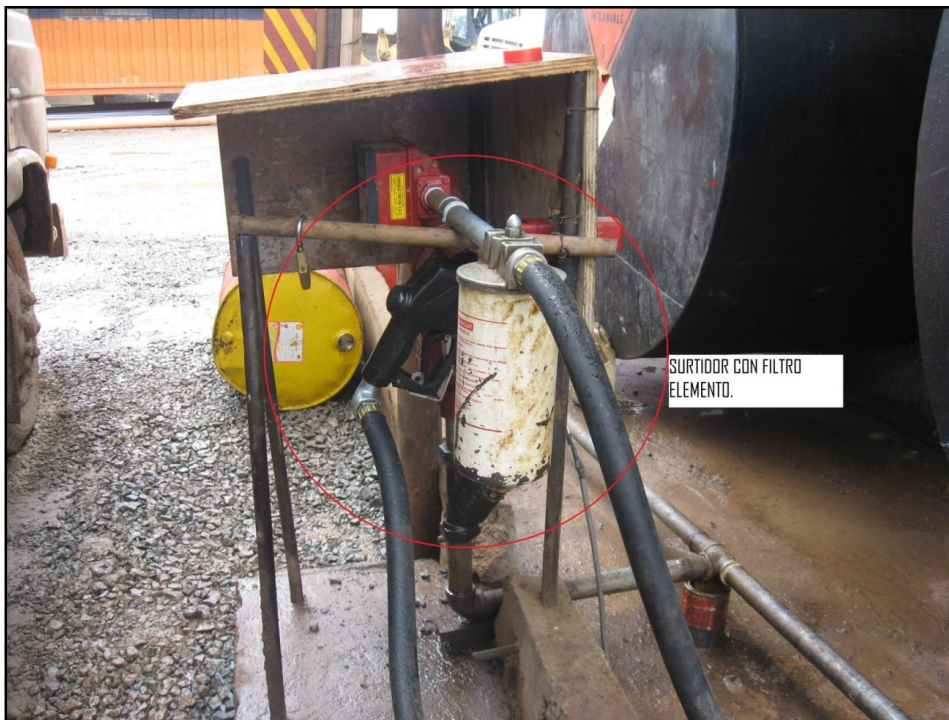
Foto. 3.3: Filtro surtidor filtra el petróleo de los Tanques 1 y Tanques 2, montado en el surtidor central. . Se usa el filtro Nro-30033, filtra partículas de 10 \mu\text{m} que pueden ser partículas de agua y sólidos.
