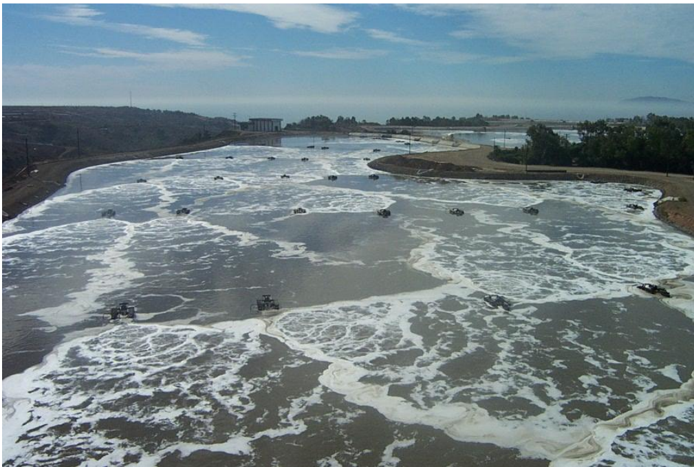
Figura 5.5: Vista de lagunas aireadas de mezcla completa (Planta San Antonio de los Buenos, Tijuana, México).
