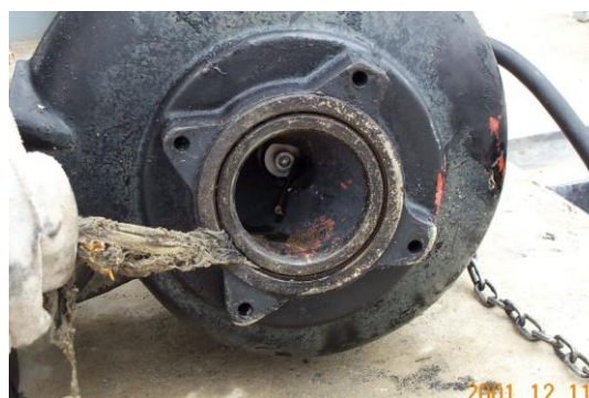
Figura 8.19: Obstrucción en bomba – Presencia de trapos.
