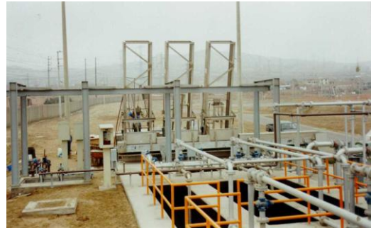
Figura 8.11: Vista de las estructuras de pretratamiento. Batería inferior.
