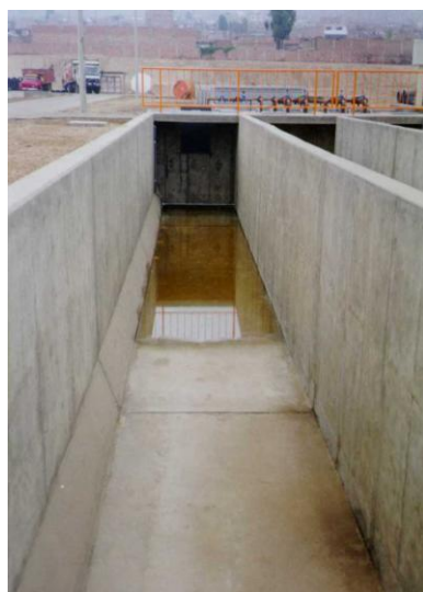
Figura N° 8.25: Punto de dosificación de Cloro.
