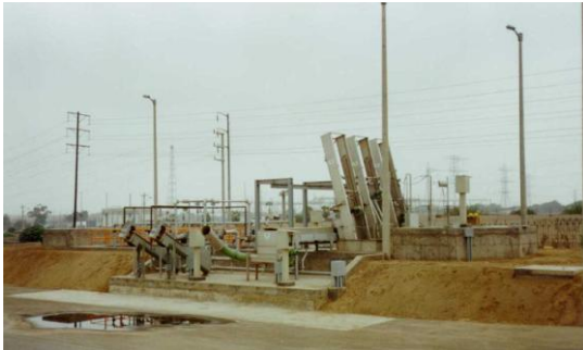
Figura 8.10: Vista de las estructuras de pretratamiento. Batería superior.
