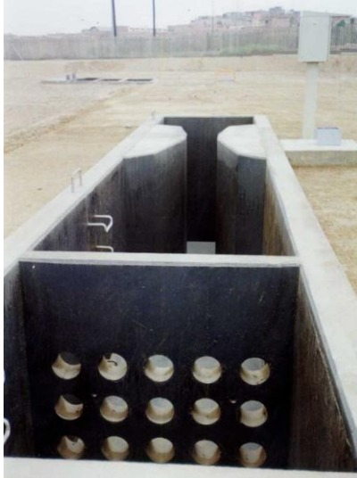
Figura 8.21: Medidor de caudal MC-1.
