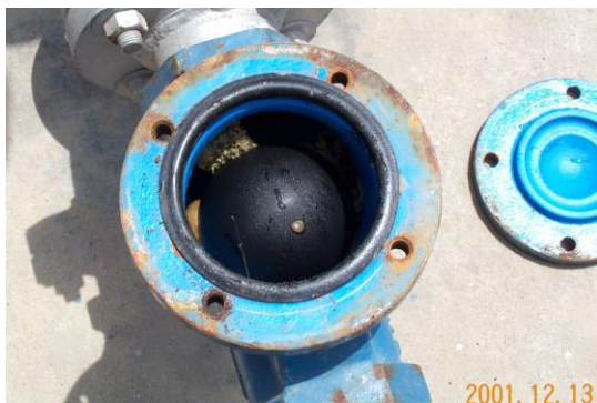
Figura 8.16: Obstrucción de válvula.
