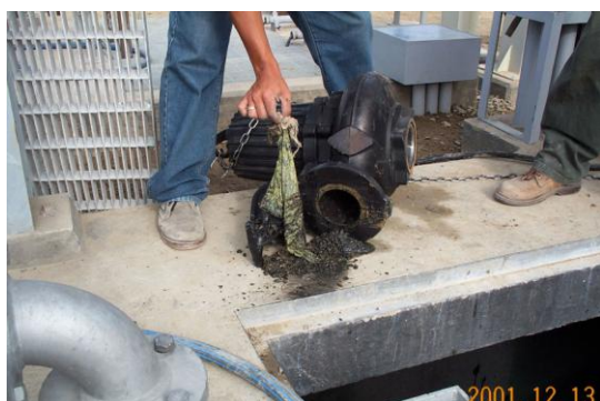
Figura 8.18: Obstrucción en bomba – Presencia de plásticos.
