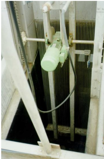
Figura 8.12: Vista de las cribas mecánicas autolimpiantes. Vista de rejillas y mecanismos de limpieza.
