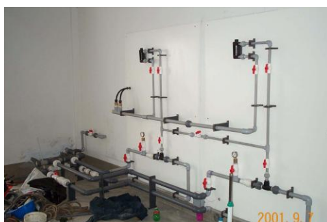
Figura 8.24: Sala de dosificación.
