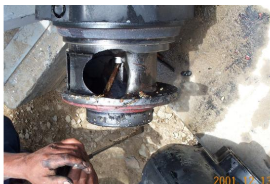
Figura 8.17: Madera en impulsor de bomba.
