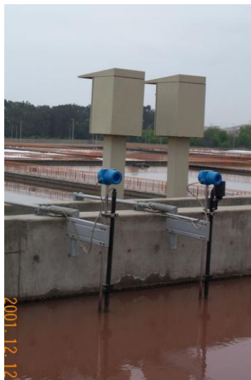
Figura 8.20: Vista de sensores de Oxígeno disuelto y pH.
