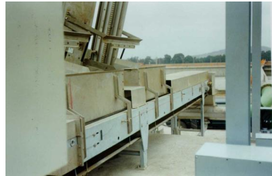
Figura 8.13: Vista de cribas mecánicas autolimpiantes. Banda transportadora de residuos.
