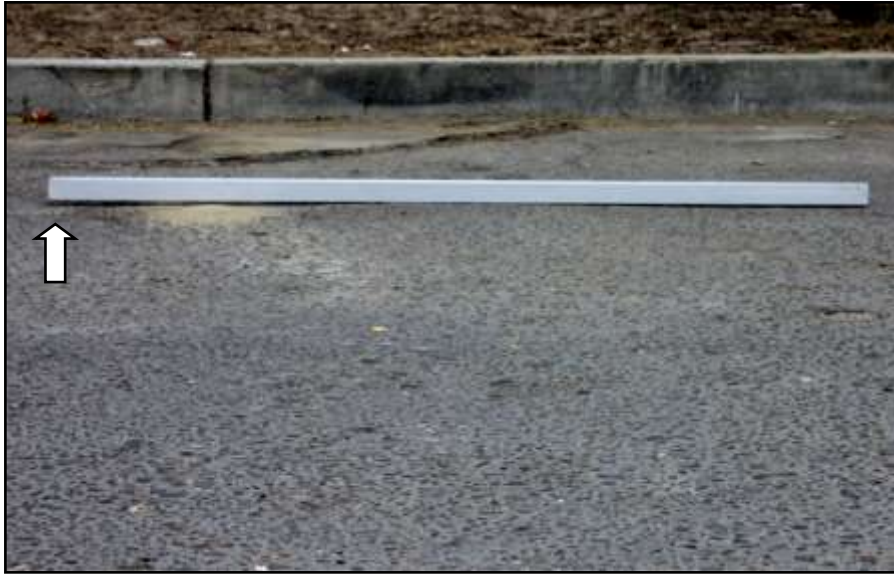
Figura 2.5. Abultamientos y hundimientos.
