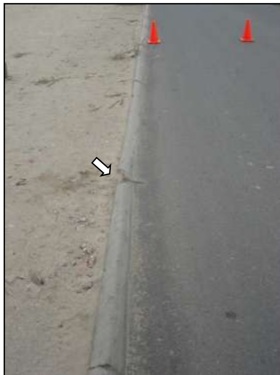
Desplazamiento de nivel bajo. Esta falla se ubica en la unidad de muestra U3, sección 1. El desplazamiento ha provocado fisuración (indicada) en una de las juntas de berma.
