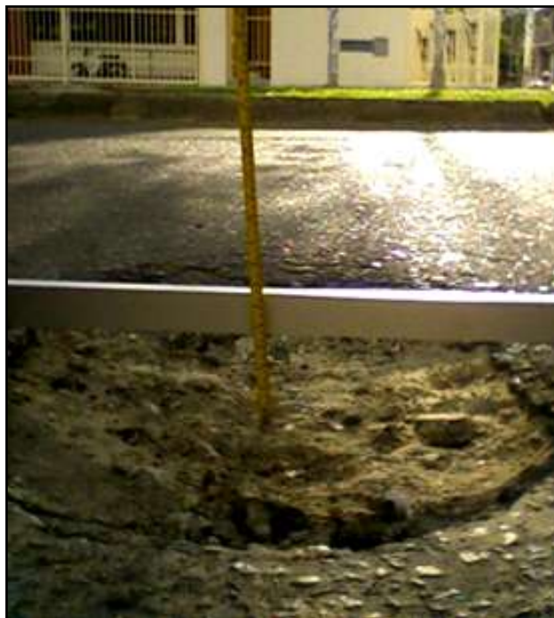
Bache de grado de severidad alto, registrado en la unidad de muestra U20, sección 3. Tiene una profundidad de 15 cm y un diámetro de 50 cm.
