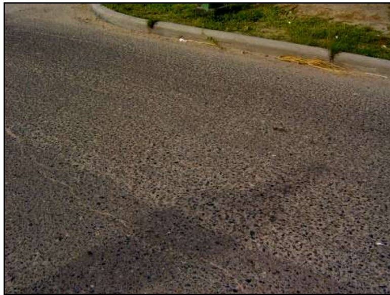
Peladura por intemperismo y desprendimiento de agregados.
