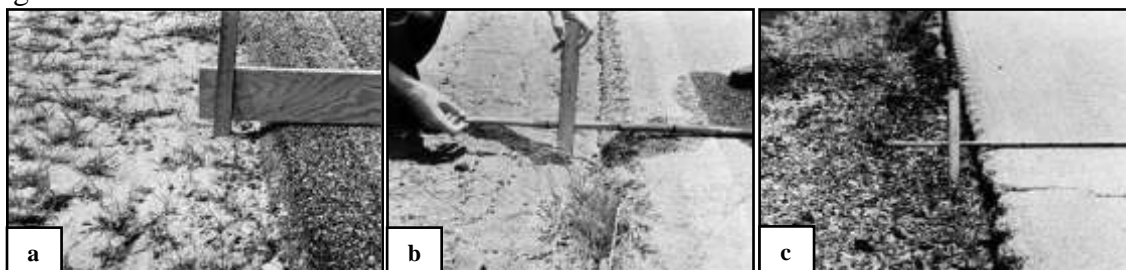
Figura 3.12. Desnivel carril – berma.
