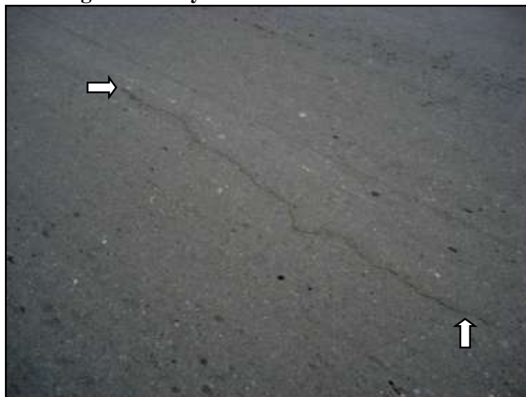
Figura 2.11. Fisuras longitudinales y transversales
