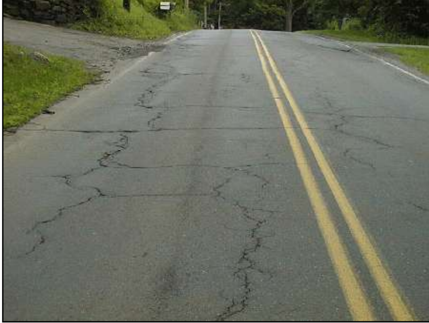
Figura 2.4. Fisuras en bloque.
