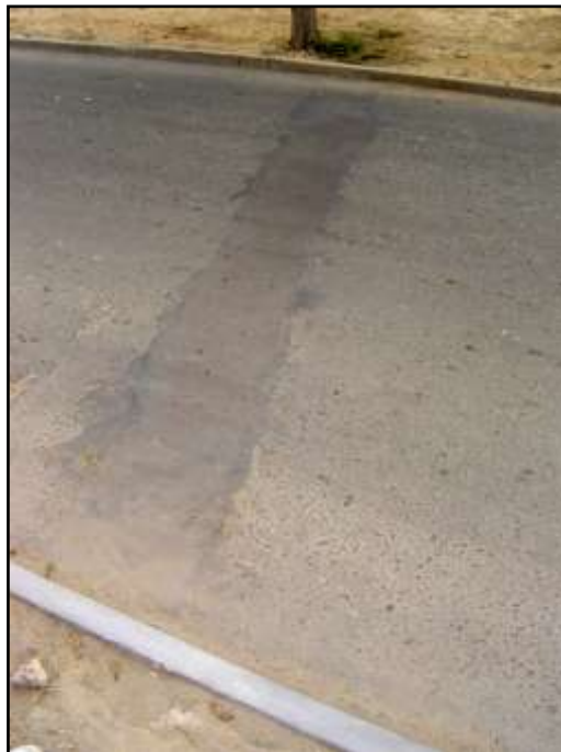
Parche de bajo nivel de severidad. Se encuentra en la unidad de muestra U23, sección 4. El parche cubre todo el ancho de vía y tiene un espesor de 60 cm.
