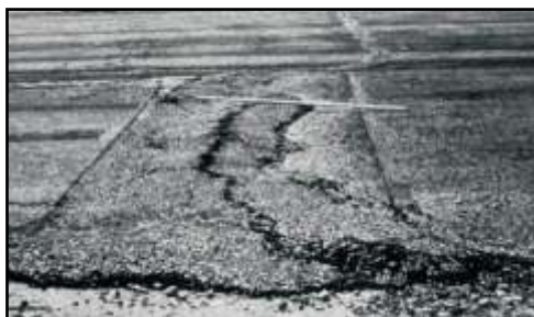
Hinchamiento de alta severidad.
