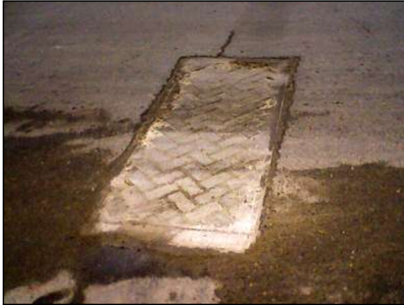
Parche de nivel de severidad medio, ubicado en la unidad de muestra U14, sección 3. Está conformado por bloquetas de concreto.
