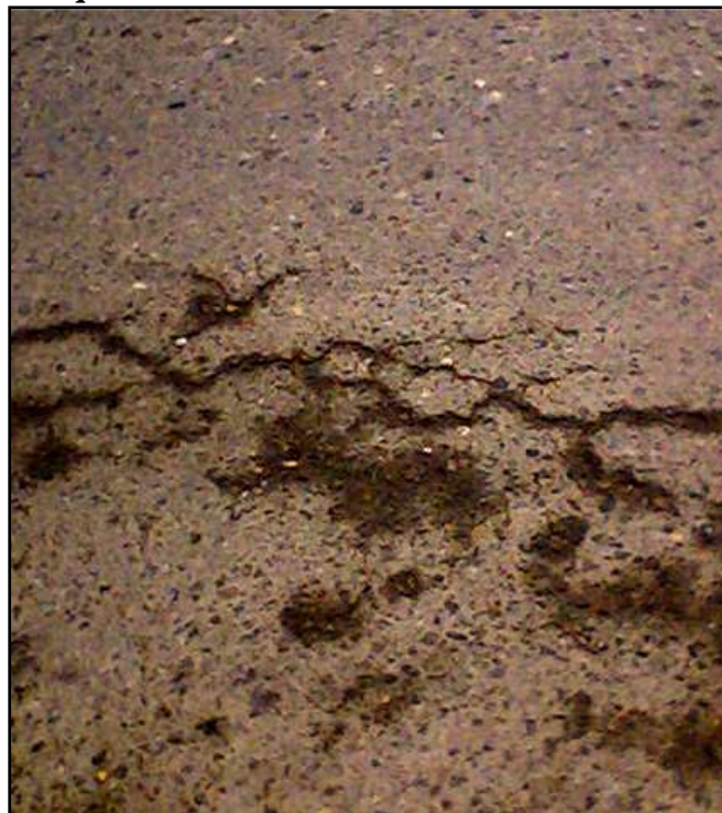
Figura 3. Fisuras en bloque.
