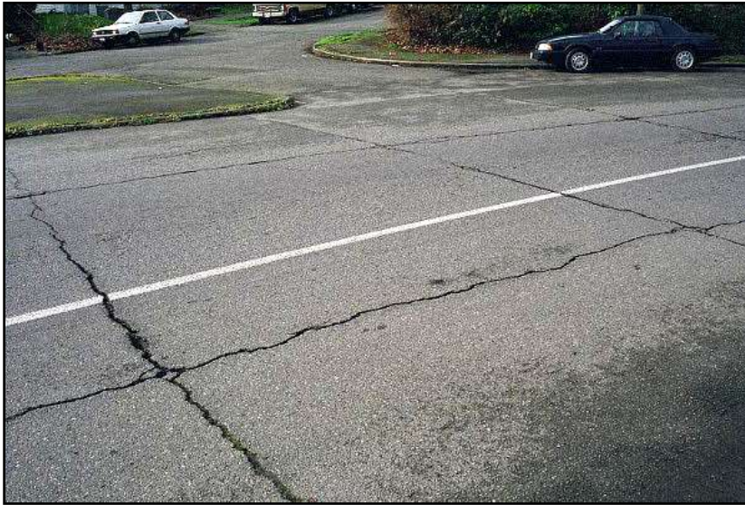
Figura 2.9. Fisura de reflexión de junta.
