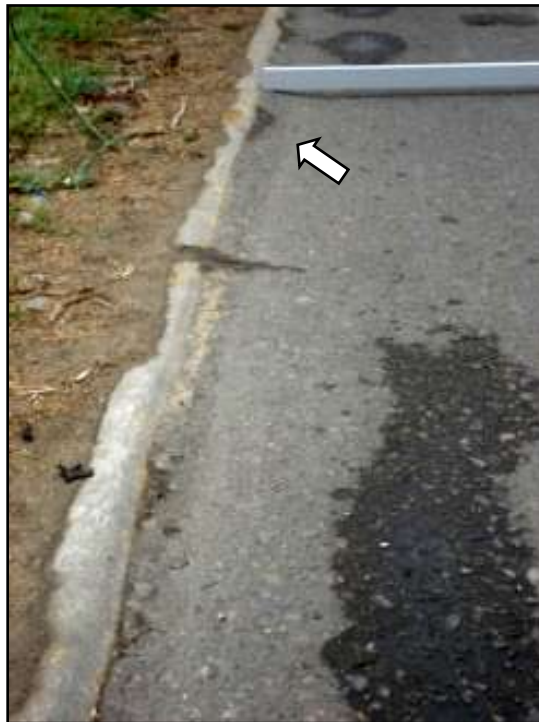
Hinchamiento de nivel bajo de severidad. Se ubica en la unidad de muestra U1, sección 1. Se observa cómo el pavimento tiene una protuberancia que intenta “trepar” a la berma.
