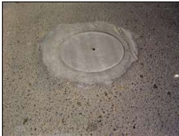
Figura 2.13. Parche de cortes utilitarios.
