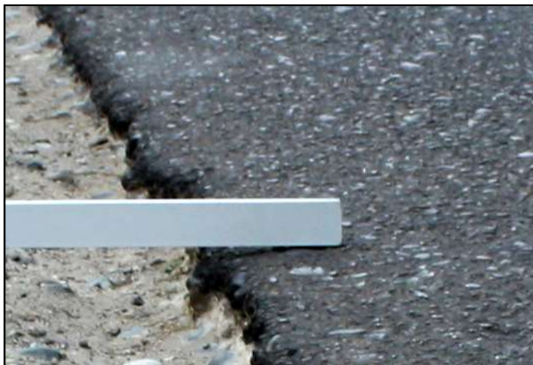
Figura 2.10. Desnivel carril – berma.
