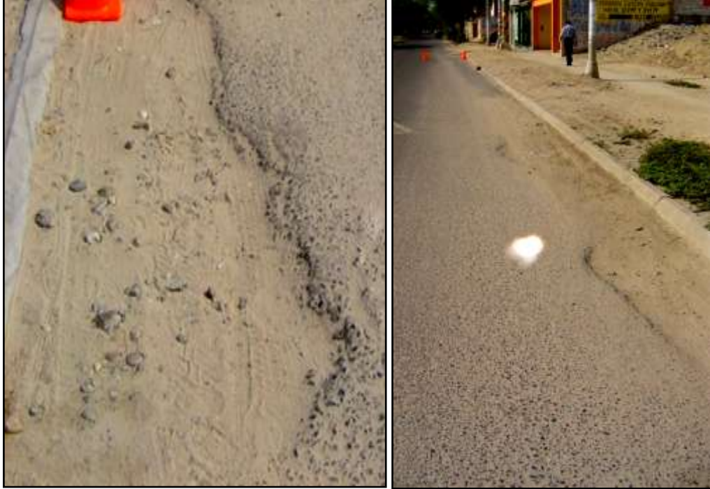
Figura 5.5. Baches de severidad media en la unidad de muestra U25.
