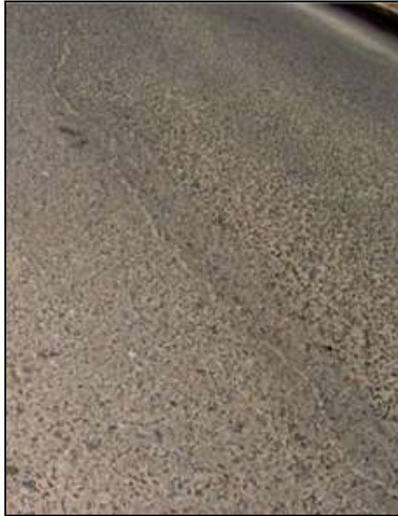
Fisura longitudinal de mediana severidad, ubicada en la unidad de muestra U25, sección 4.
