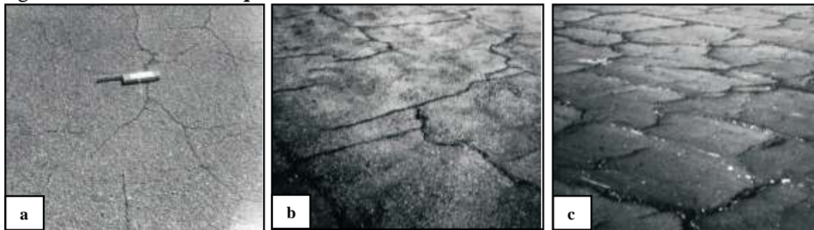
Figura 3.6. Fisuras en bloque.
