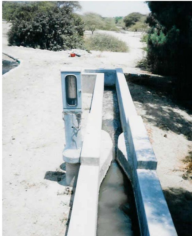
Foto A3. Medidor Parshall en estructura de entrada.
