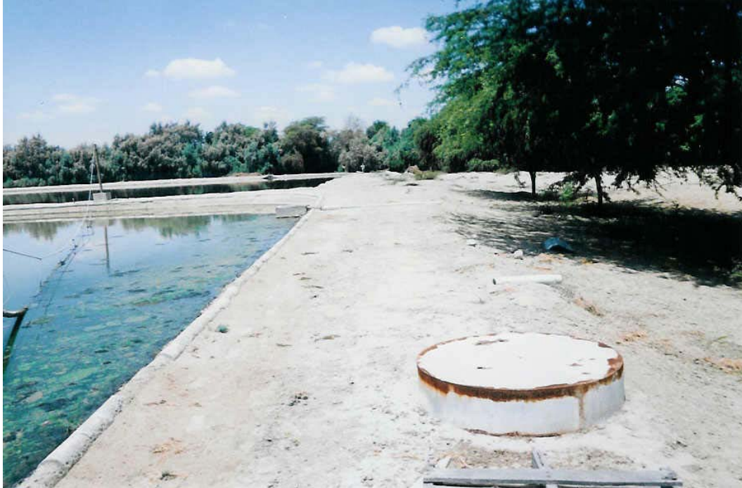
Foto A7. Tanque para la medición de la evaporación en mal estado.
