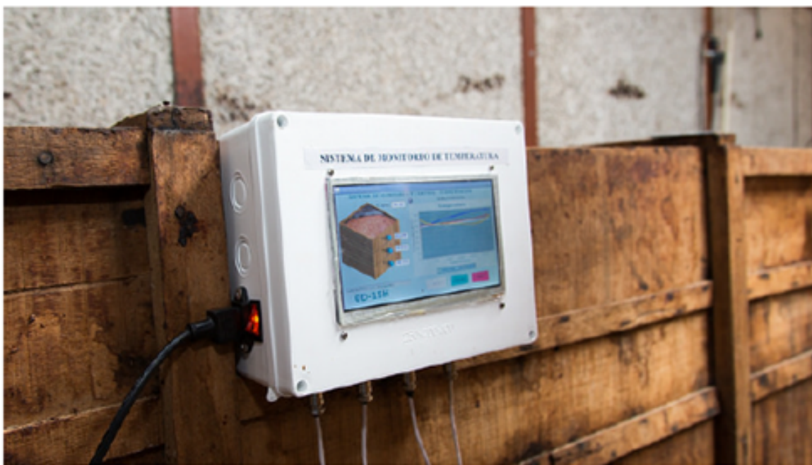
Figura 12. Prototipo IoT instalado en sala de fermentación
