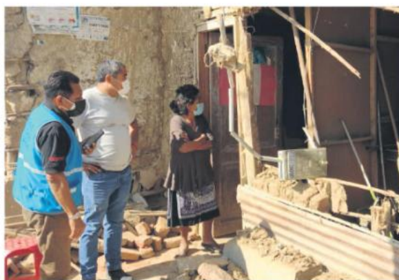
DAÑOS. La Municipalidad de Castilla, en la provincia de Piura, reporta 12 viviendas afectadas a causa de movimiento sísmico.
