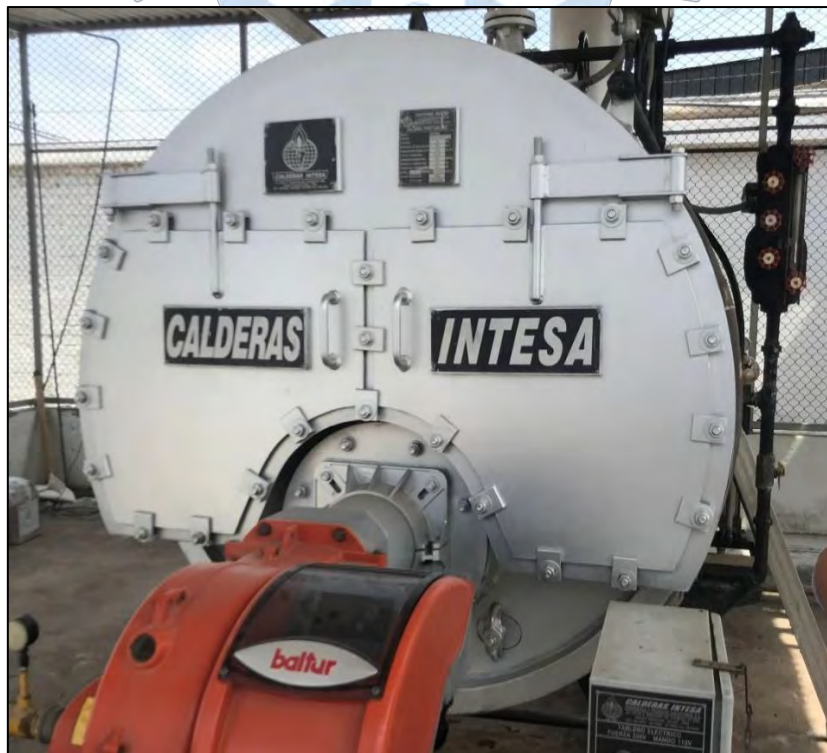
Figura 16. Caldera a gas que utiliza una bomba eléctrica para la distribución de agua
