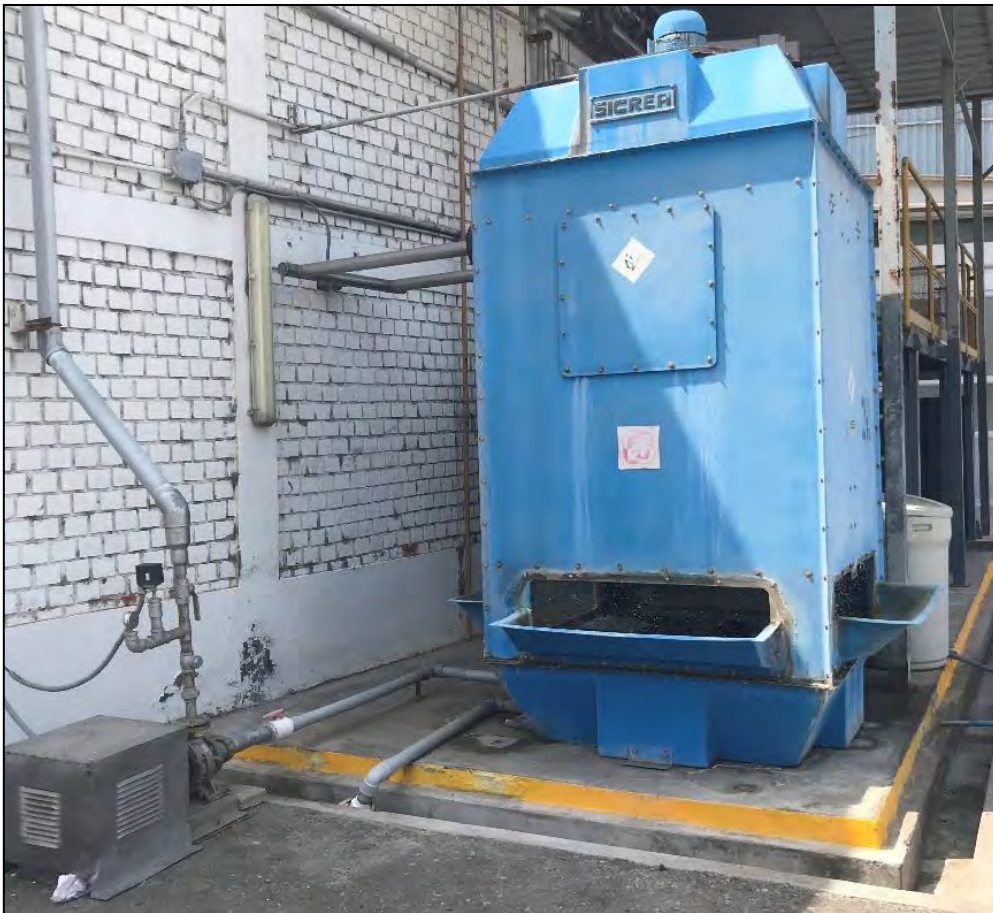
Figura 17. Torre de enfriamiento SICREA junto a su respectiva bomba eléctrica
