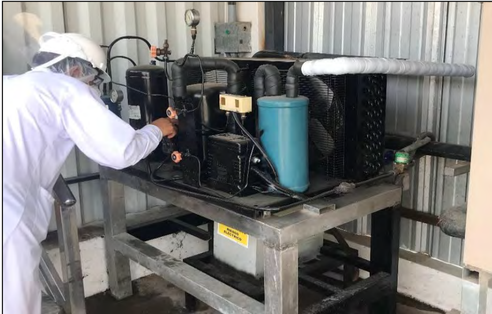
Figura 18. Sistema de refrigeración utilizada por los tanques internos donde se almacena la leche utilizada
