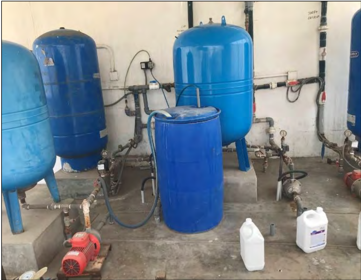
Figura 27. Sistema hidroneumático encargados de abastecer de agua a toda la fábrica
