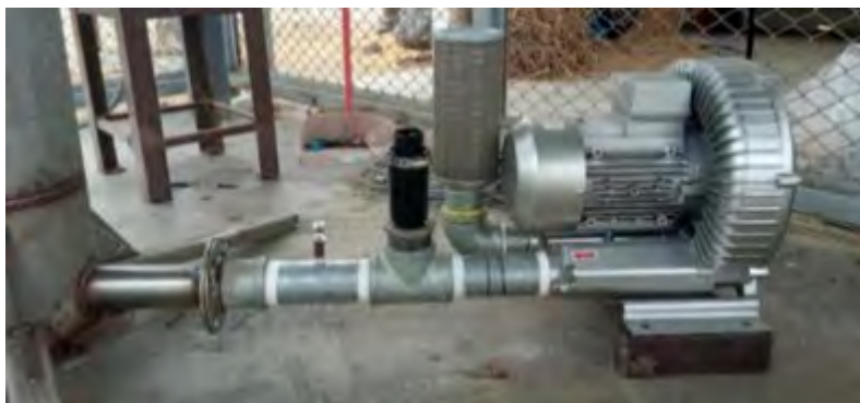
Figura 25. Sistema del blower.
