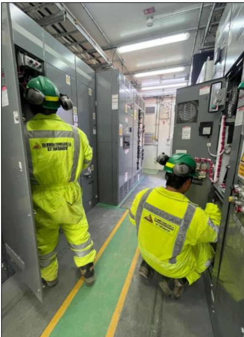
Figura 40 Limpieza de contactores
