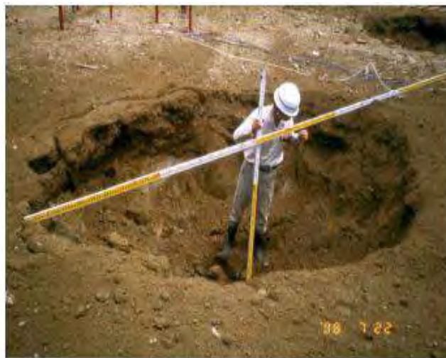
Figura 23: Medida de descenso de huella, control topográfico.
