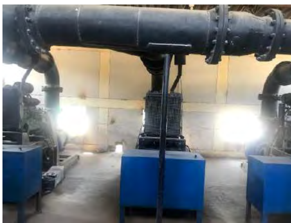
Figura 18 Sala de operaciones de la cámara de bombeo
