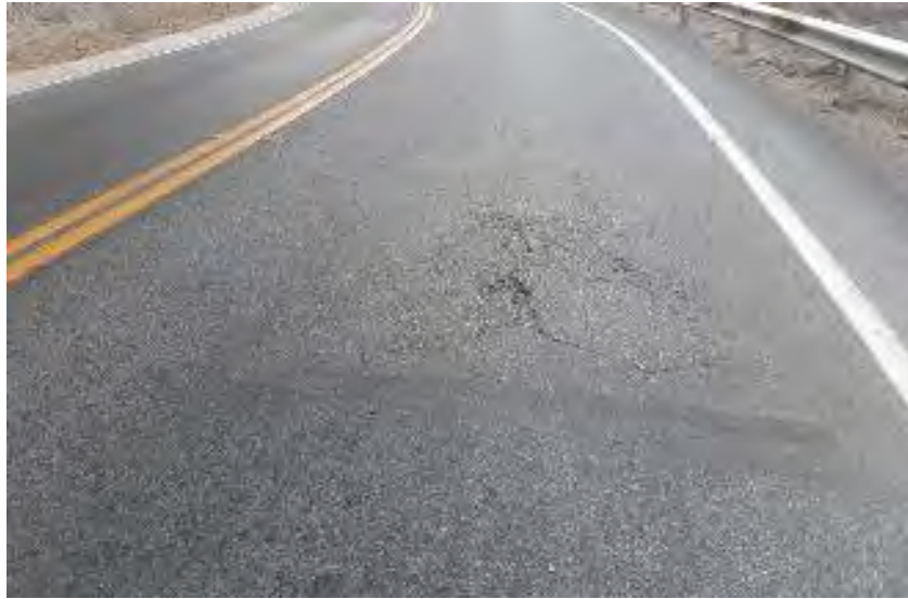
Figura 3: Peladuras y baches, carretera central Km 59+830
