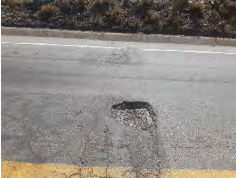
Figura 15: Baches y fisuras en bloque Carretera central Km 137+100
