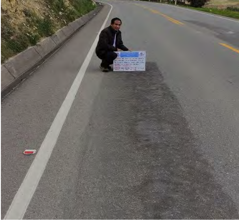
Figura 17: Fisuras transversales, corrimiento y peladuras Carretera central Km 160+800
