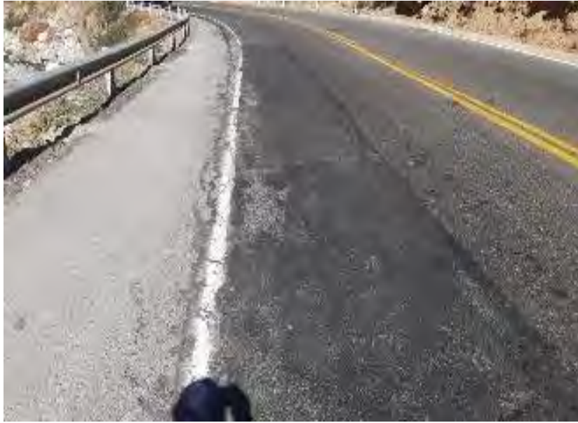
Figura 5: Peladura y corrimiento Carretera central Km 82+530
