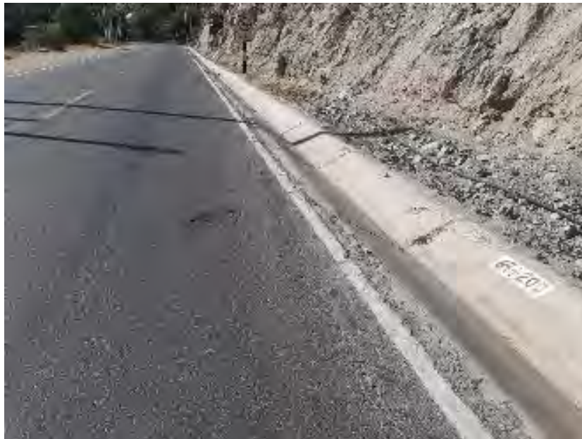
Figura 4: Ahuellamiento y peladura Carretera central Km 64+200
