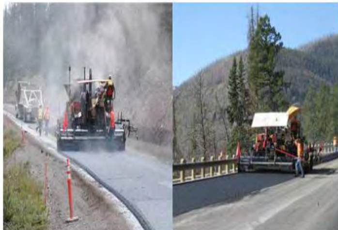
Figura 37: Efectos ambientales durante extendido de las mezclas asfálticas Fuente: Torres y Noreña, 2012
