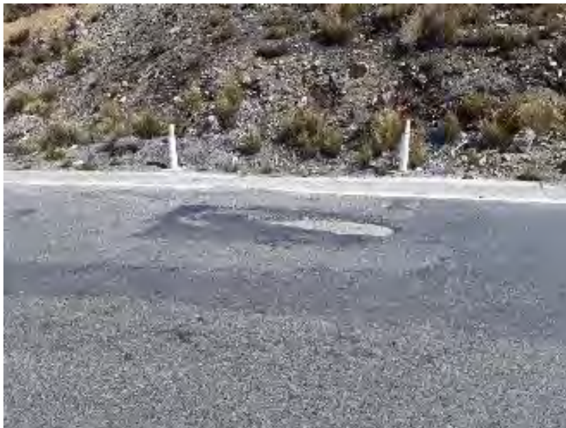
Figura 14: Baches y peladuras Carretera central 132+730
