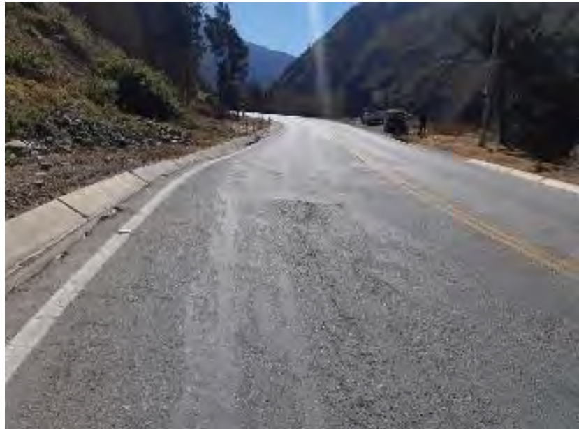
Figura 8: Fisuras, peladura y baches Carretera central Km 92+210
