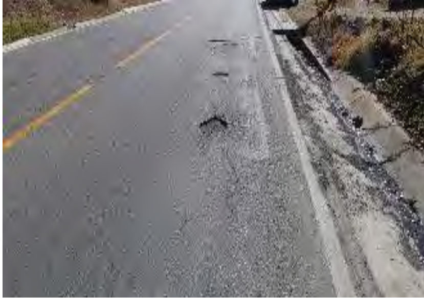
Figura 7: Baches y peladuras Carretera central KM 92+080
