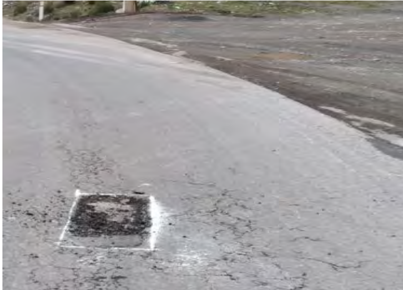
Figura 19: Piel de cocodrilo Carretera Oroya Pasco
