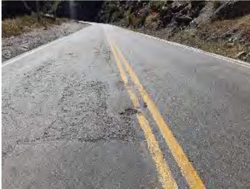
Figura 11: Peladuras y baches Carretera central Km 98+690
