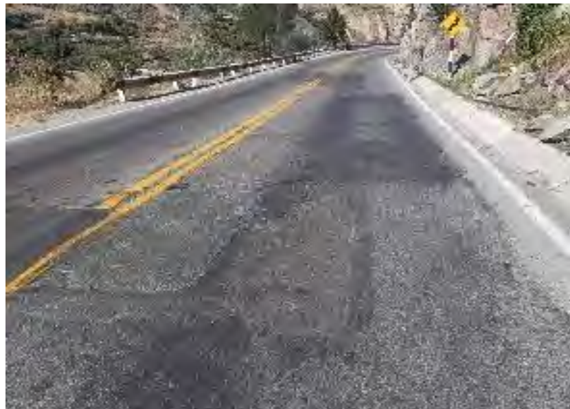
Figura 2: Desprendimiento por peladuras Carretera central Km 68+650
