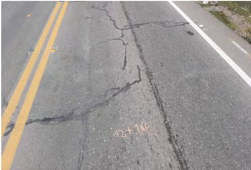
Figura 18: Fisuras en bloque, fisura longitudinal Carretera Oroya Pasco Km 12+160
