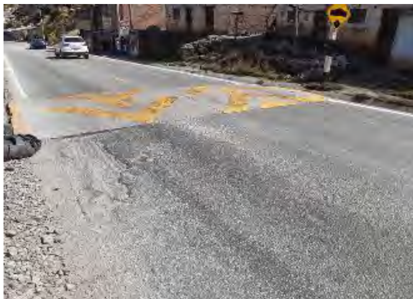
Figura 12: Rotura de bordes y peladuras Carretera central Km 115+630
