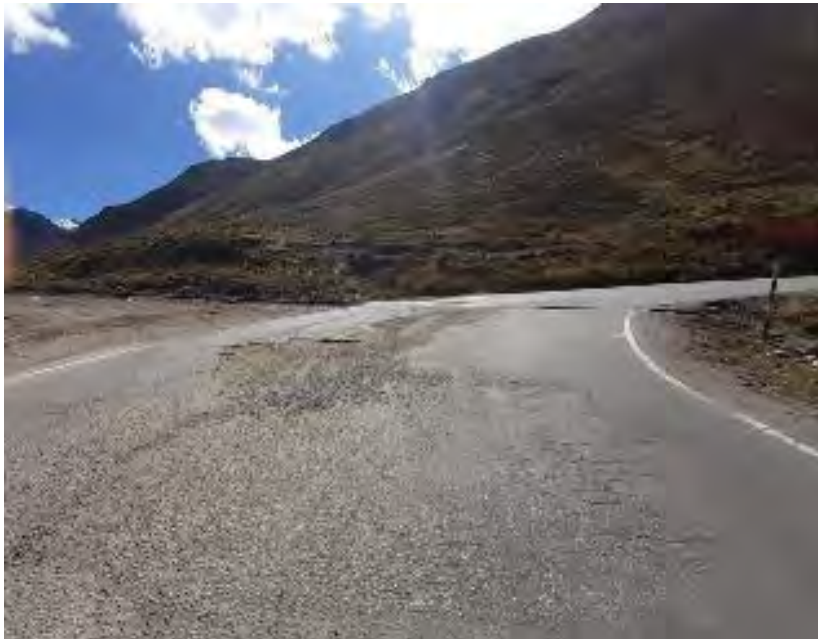
Figura 13: Esguerrimiento, baches y peladuras Carretera central Km 119+200
