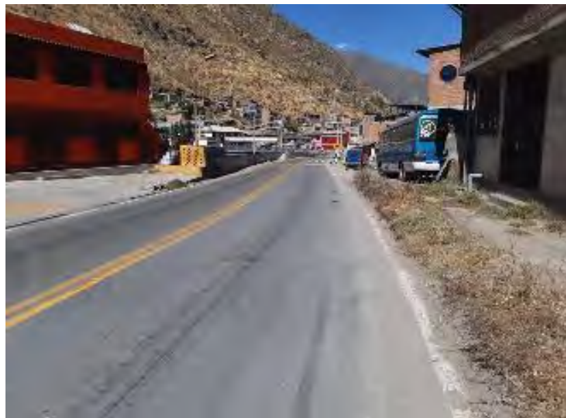
Figura 10: Ahuellamiento y fisuras carretera central Km 94+310
