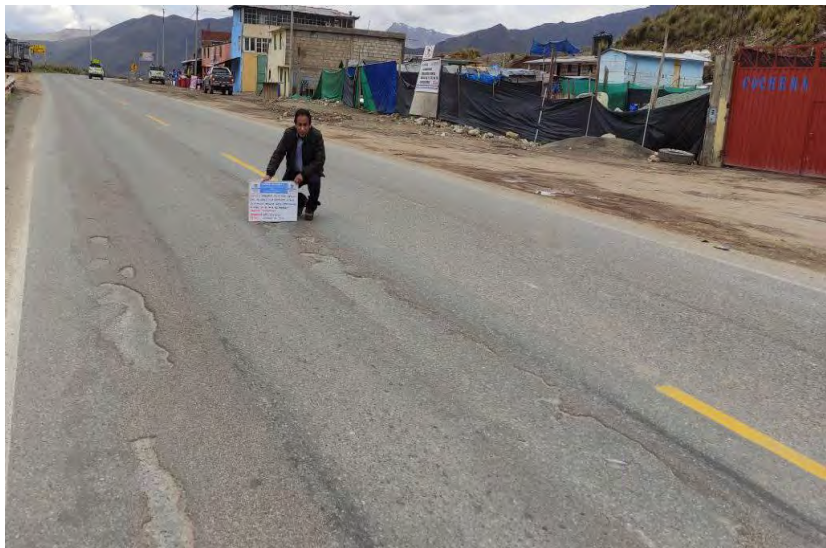
Figura 16: Ahuellamiento, corrimiento y peladuras Carretera central Km 149+850
