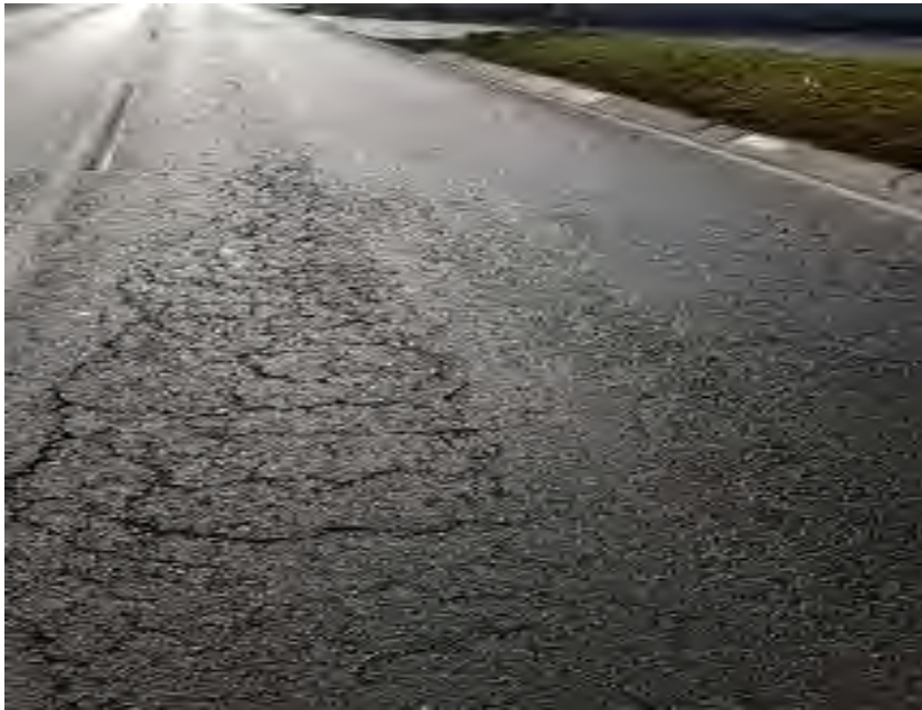
Figura 1: Piel de cocodrilo carretera centra Km 43+800
