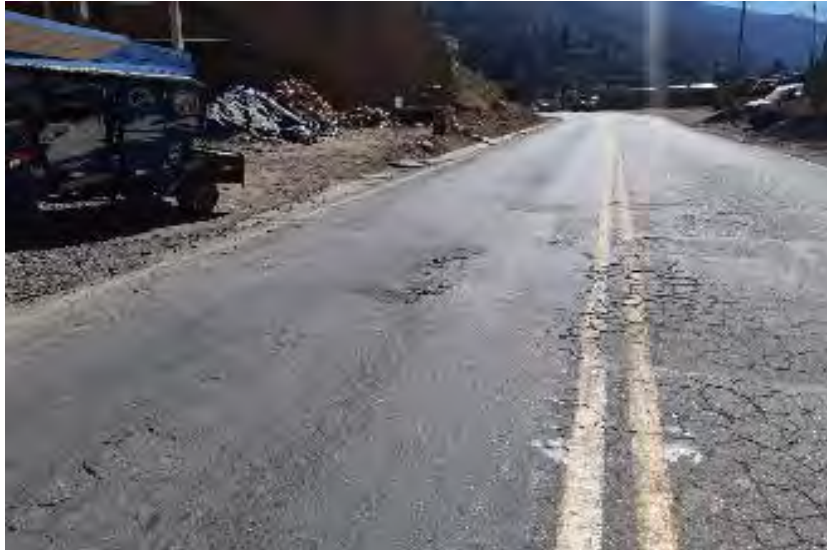
Figura 9: Piel de cocodrilo y ahuellamiento Carretera central Km 92+780
