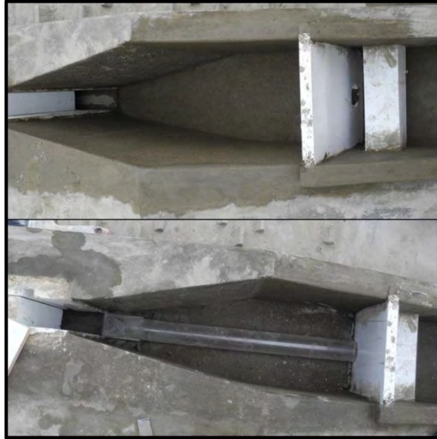
Figura 4.16. Túnel de caudal ecológico.
