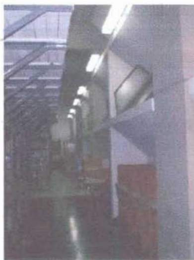
d) Iluminación de pasillo de noche
