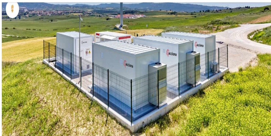
Figura 36. Planta de almacenamiento con energía eólica
