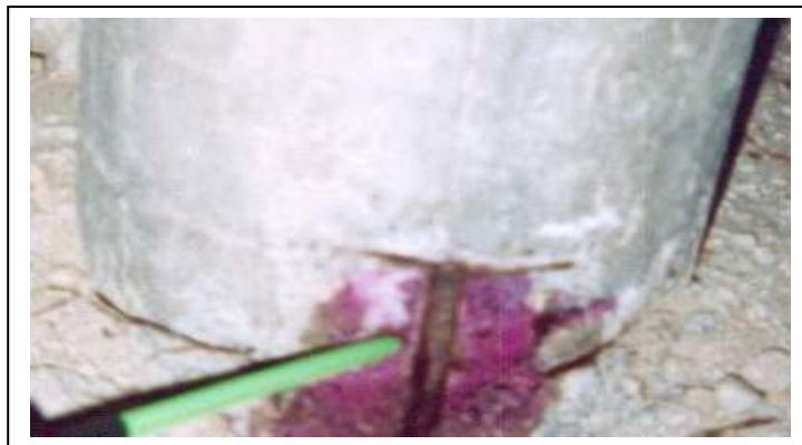
Fig. 3.3.2.1.- Detalle del cambio de coloración del concreto, por aplicación de Fenolftaleína
