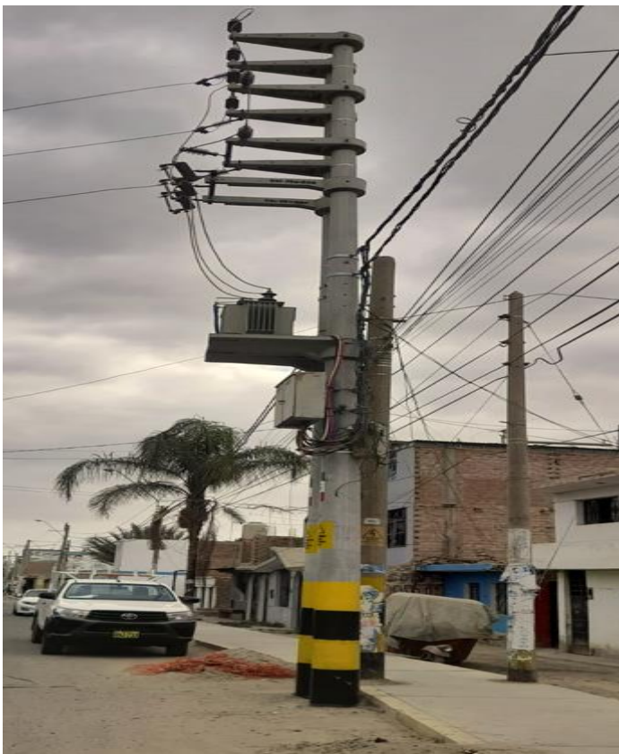
Sub-Estación aérea biposte (SAB) con transformador reductor
