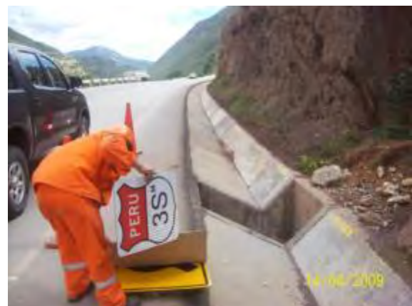
Foto 2.21 Paneles de señales verticales
