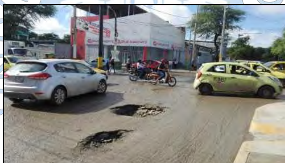
Figura 22. Baches de gran magnitud en la ciudad de Piura, siendo un riesgo para el usuario.
