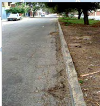
Figura 12. Fisura de borde.
