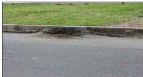
Figura 21. Hinchamiento en pavimento flexible.
