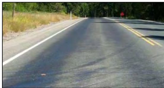
Figura 24. Exudación en pavimentos asfálticos.
