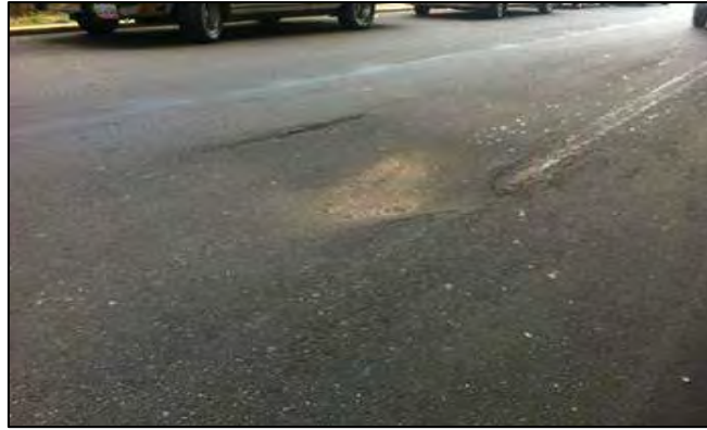
Figura 16. Abultamiento y hundimiento del pavimento.
