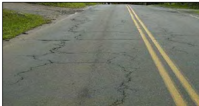
Figura 11. Fisura en bloque en pavimento flexible.
