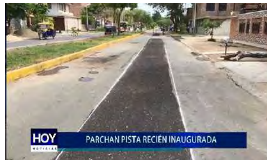
Figura 27. Parche en pavimentos flexibles.
