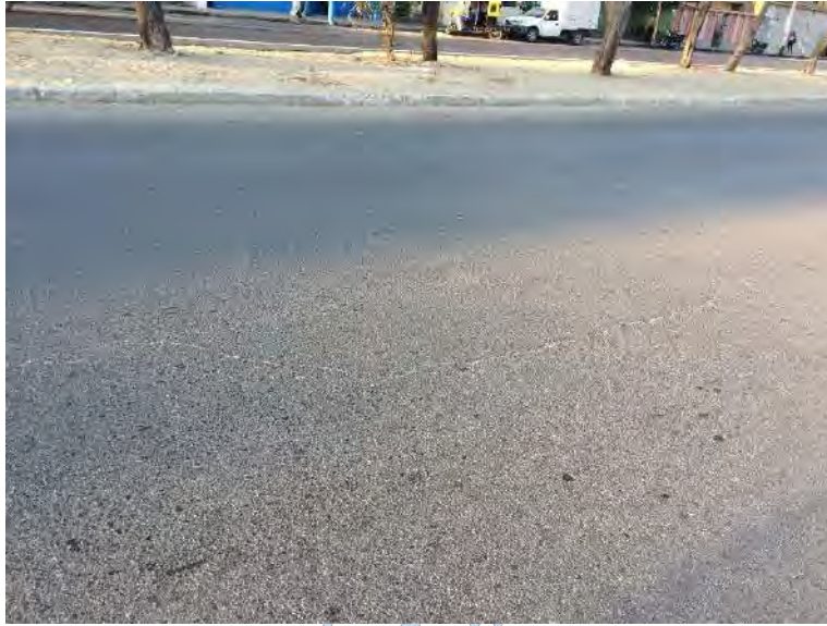
Figura D3. Fisura longitudinal de severidad media en la unidad UM29.
