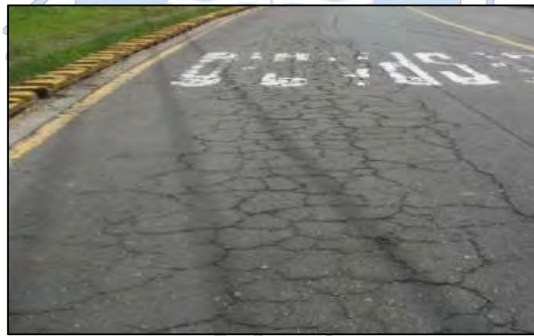
Figura 10. Piel de cocodrilo en pavimento flexible.
