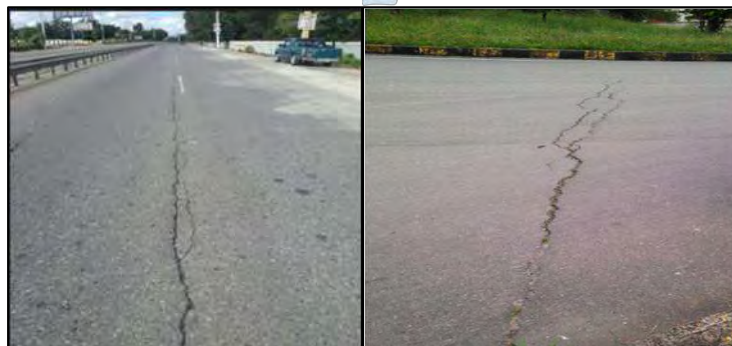
Figura 14. Fisuras longitudinales y transversales.
