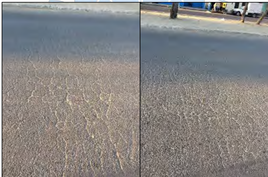
Figura D2. Piel de cocodrilo de severidad media encontrada en la unidad UM29
