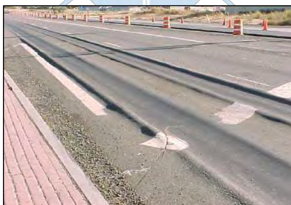
Figura 19. Ahuellamiento en pavimento flexible.
