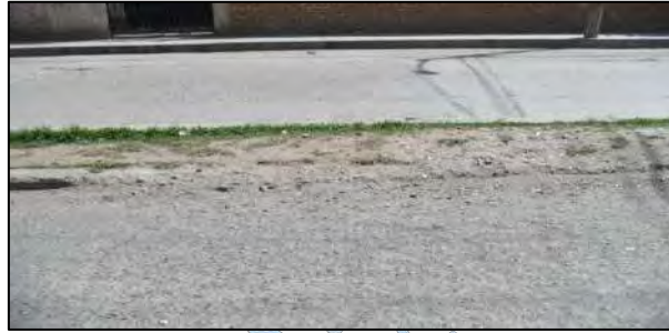
Figura 23. Peladura y desprendimiento de agregado.
