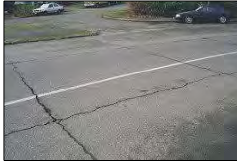
Figura 13. Fisura de reflexión de junta.
